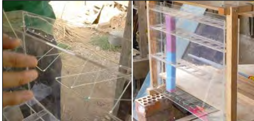
Fotografía N° 5.7: Soporte del Reactor con Hilo de Pescar
