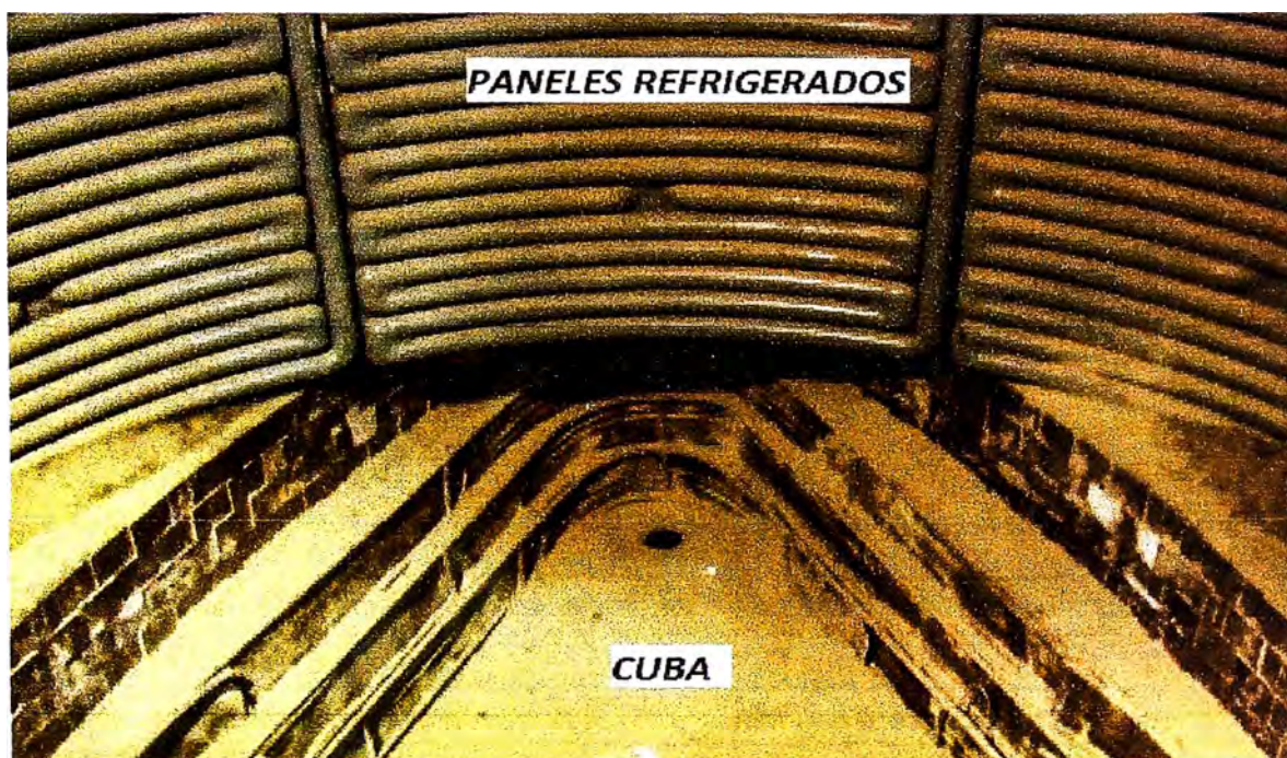
Figura 3.6 Paneles Refrigerados zona EBT
