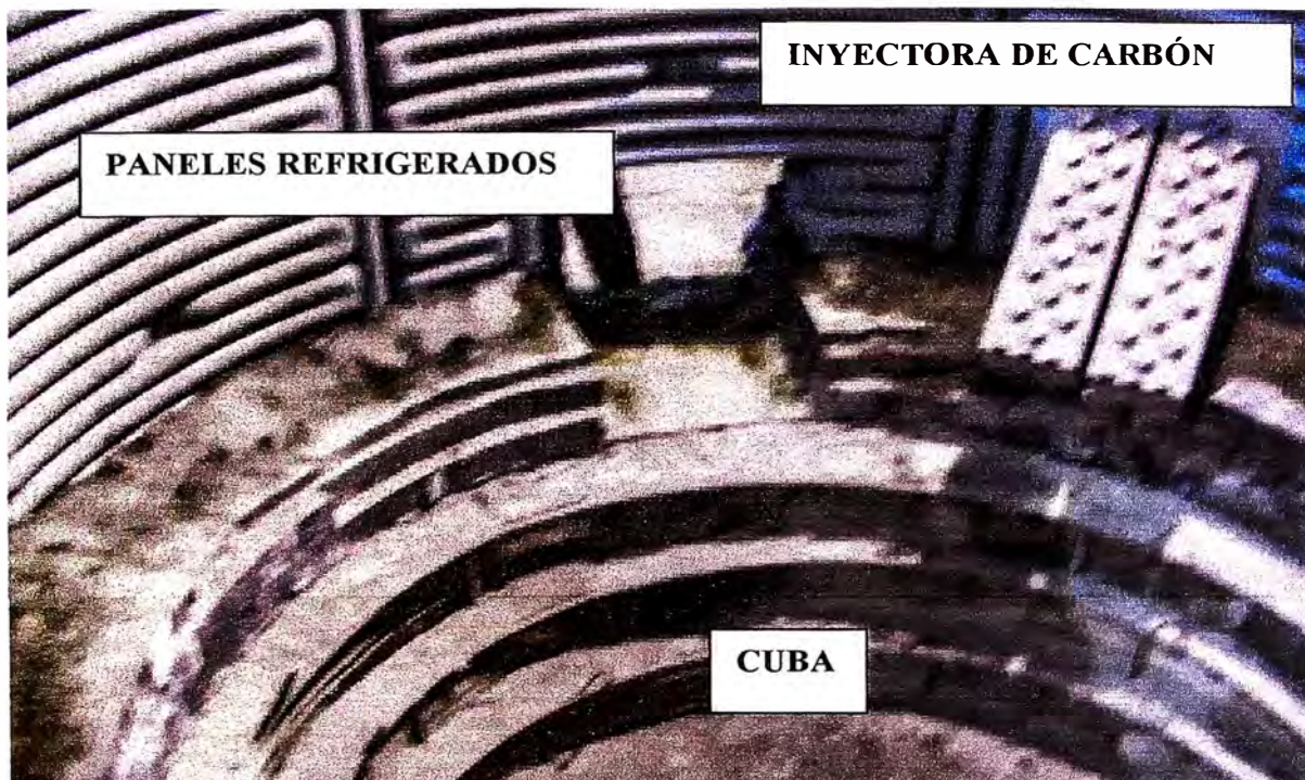
Figura 3.7 Paneles Refrigerados zona puerta de escoreo
