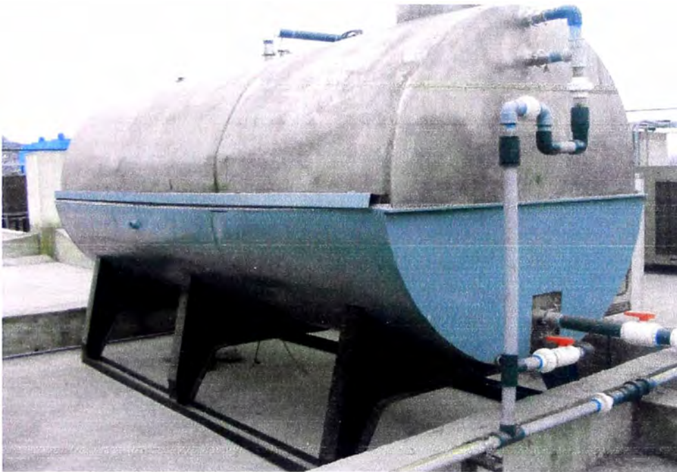
Figura 4.24. Tanque de almacenamiento.
