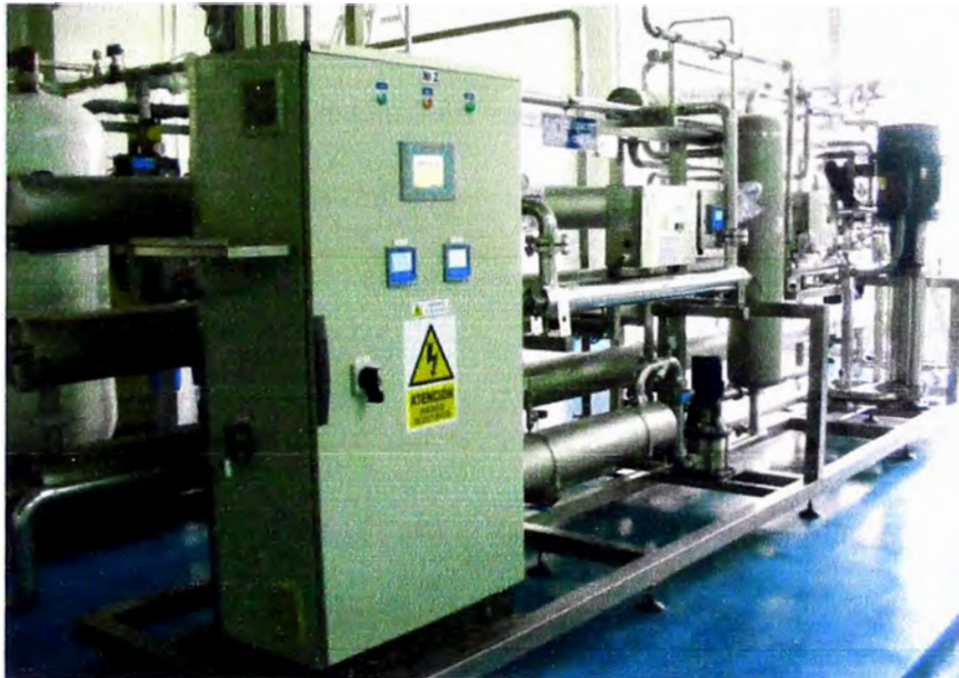
Figura 2.4. Equipo de osmosis inversa IPA.
