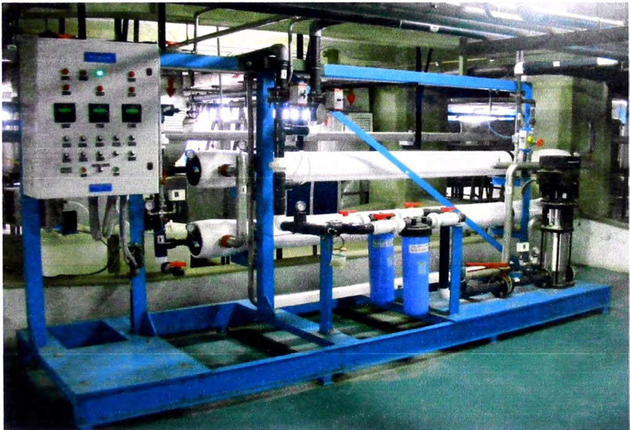
Figura 4.23. Equipo de ósmosis inversa ensamblado.
