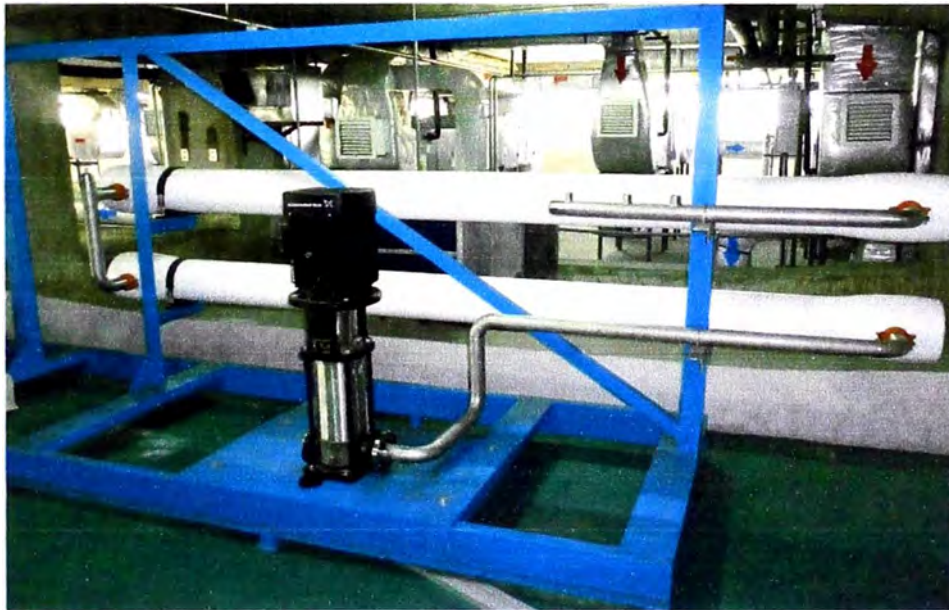
Figura 4.21. Estructura metálica, bomba de alta presión, housing y tuberías de acero inoxidable.
