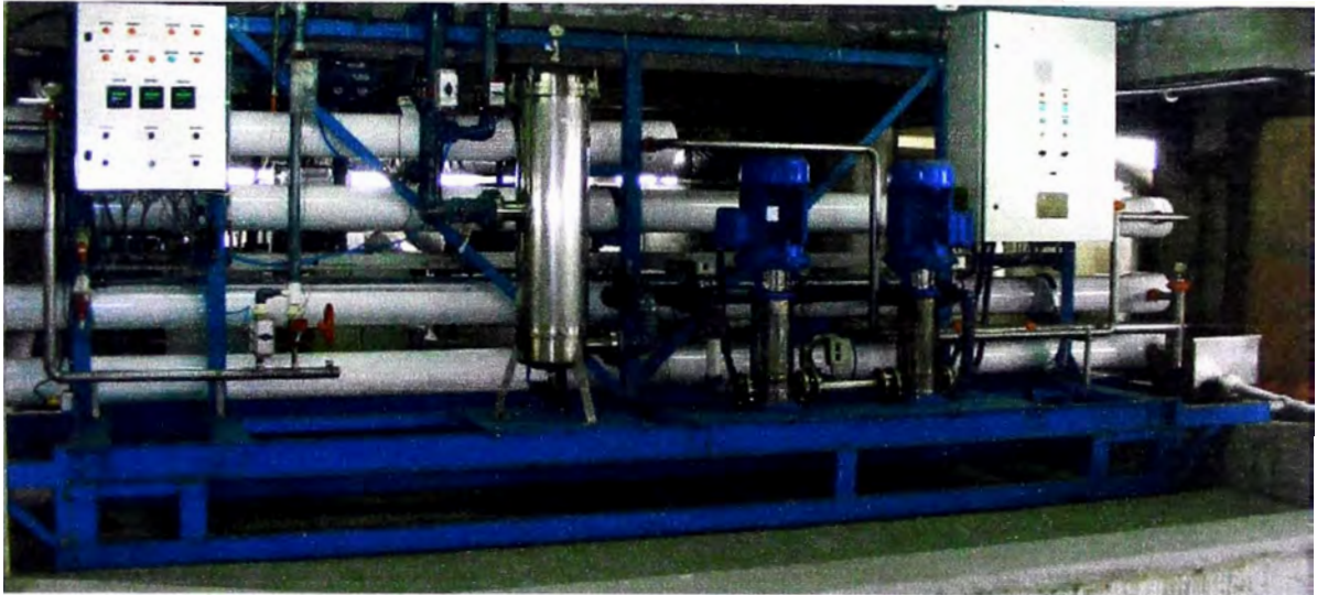
Figura 2.3. Equipo de osmosis inversa Accuaproduct.
