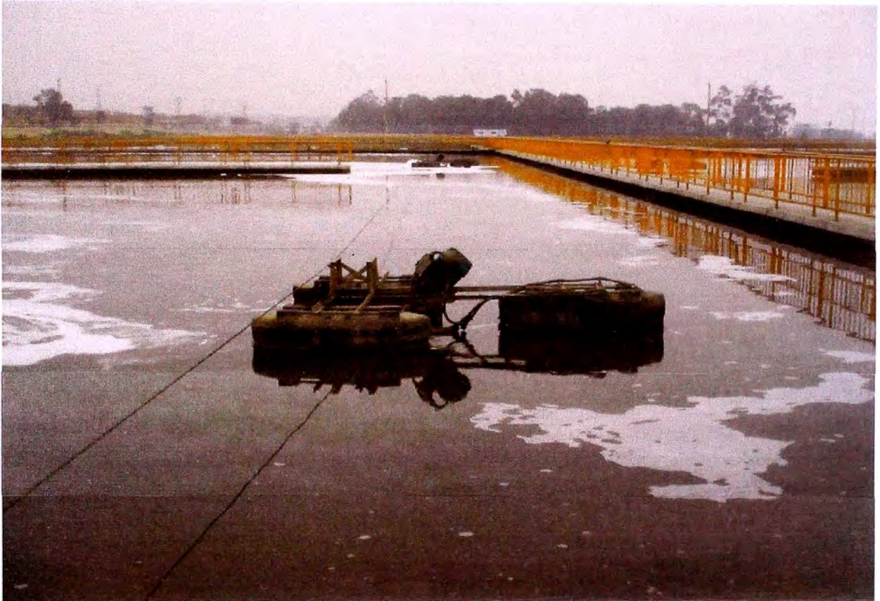
Fig. 3.2 Aereador horizontal 20 HP- AIRE O 2 en operación
