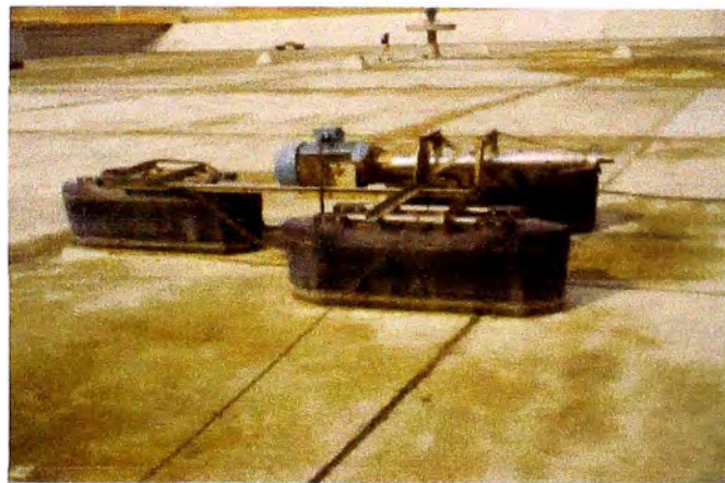
FIG 4.2 Aereador 20 hp- aire O 2 en mantenimiento laguna LAMC - PTAR SAN JUAN
