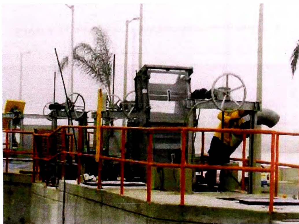
Fig. 2.12. Unidad de pre-tratamiento – PTAR HUASCAR
