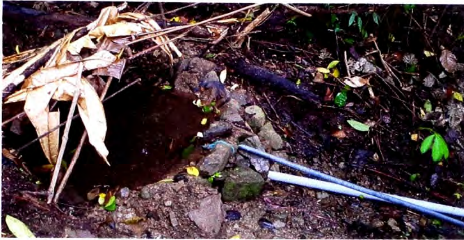
FOTOGRAFÍA N° 4.3: Vista actual de la captación N°02
