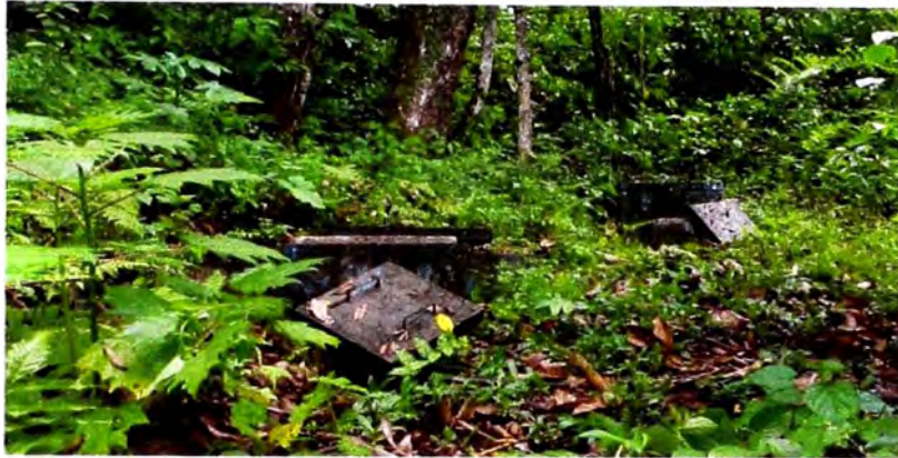
FOTOGRAFÍA N° 4.2: Vista actual de la captación N°01
