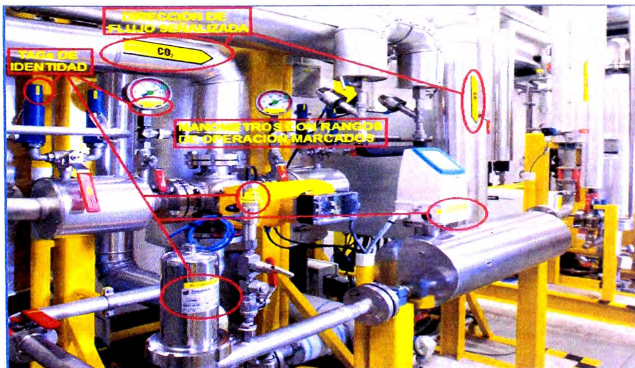
Figura 4.13: Señalética aplicada a una planta de recuperación HAFFMANS de dióxido de carbono de SAB Miller en Republica Checa,
