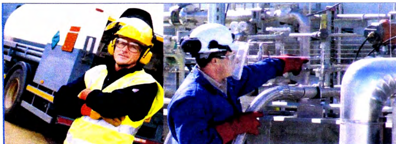
Figura 4.12: Equipo de protección individual, EPIs para la descarga de dióxido de carbono
