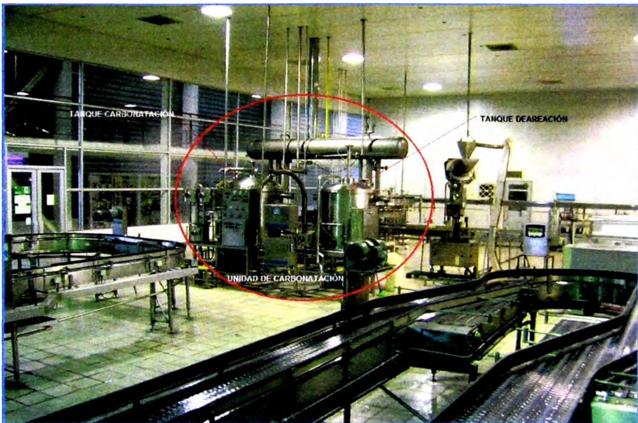
Figura 4.4: Unidad de carbonatación - Tanque de carbonatación y tanque de deareación. Fuente: http://www.taringa.net/posts/info/10809987/Como-se-elabora-la-Coca-cola-Dentro-de-la-fabrica_.html /viernes, 30 de noviembre de 2012, 11:46:37 a.m.-Pta. Embonor –Chile.
