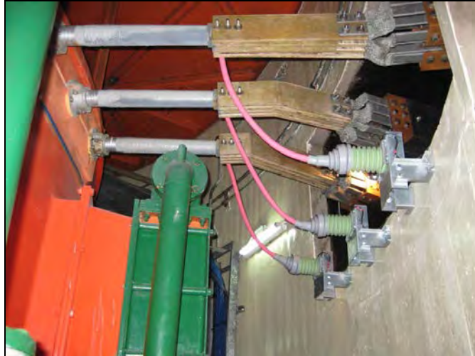
Figura 4. 3: Acoplador Capacitivo en Unidad 7 C.H. SAM – Electroperu S.A.
