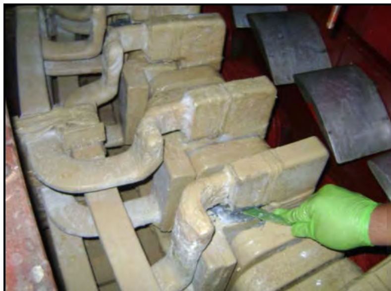
Figura 6. 52: Aplicación de la resina en las partes afectadas de los cabezales superiores
