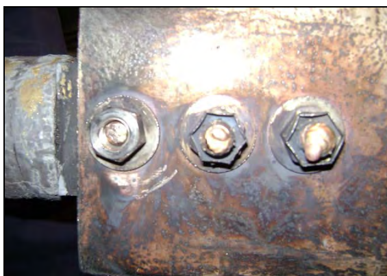
Figura 6. 13: Pernos de sujeción de salida 13.8 kV fundidos
