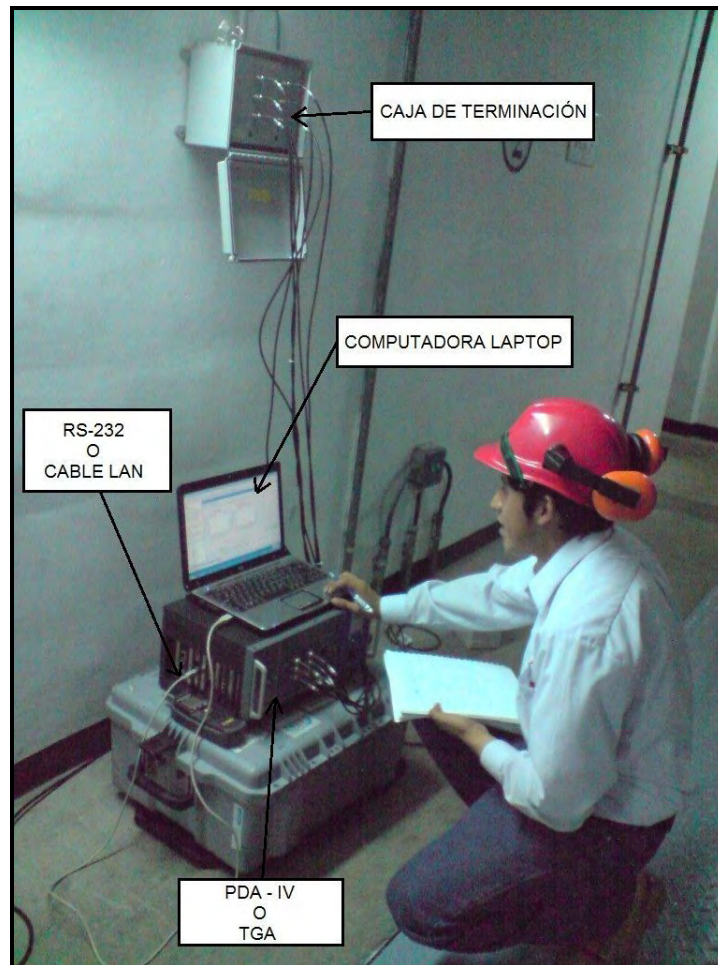
Figura 4. 32: Conexionado para el monitoreo de DP
