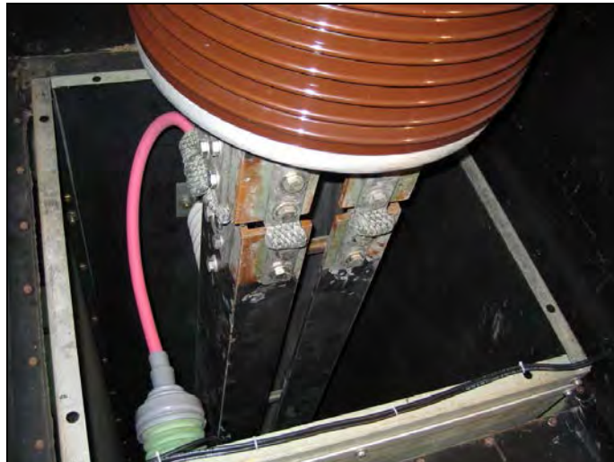
Figura 4. 4: Sistema acopladores fase "S" Unidad 7 C.H. SAM - Electroperu S.A.
