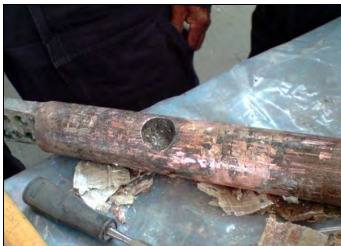
Figura 6. 20: Barra de cobre afectada por el cortocircuito
