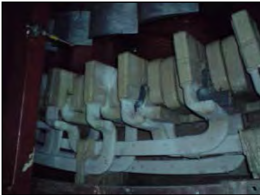
Figura 6. 46: Indicio de descargas parciales (polvo blanco/ozono).
