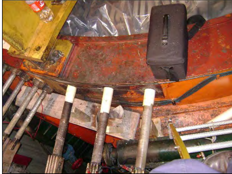
Figura 6. 14: Salida de barras 13.8 kV
