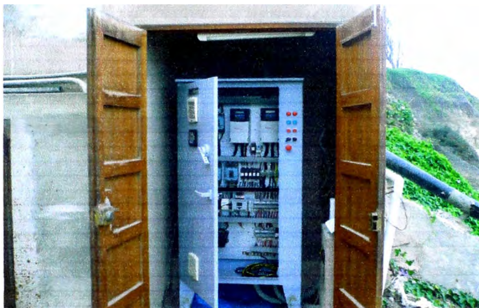
Foto 4.3: Tablero de control de bombas centrifugas.
