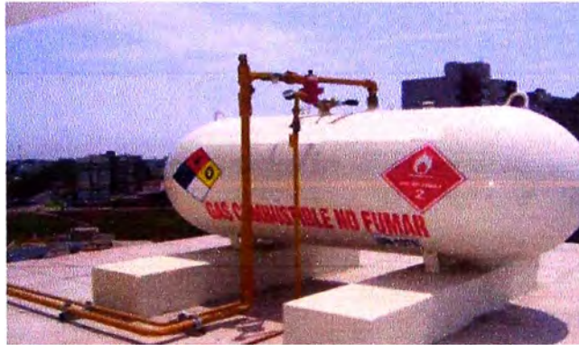
TANQUE DE GLP Figura 4,5
