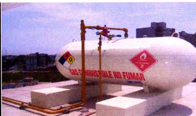
TANQUE DE GLP UBICADO EN EL TECHO Figura 2,2
