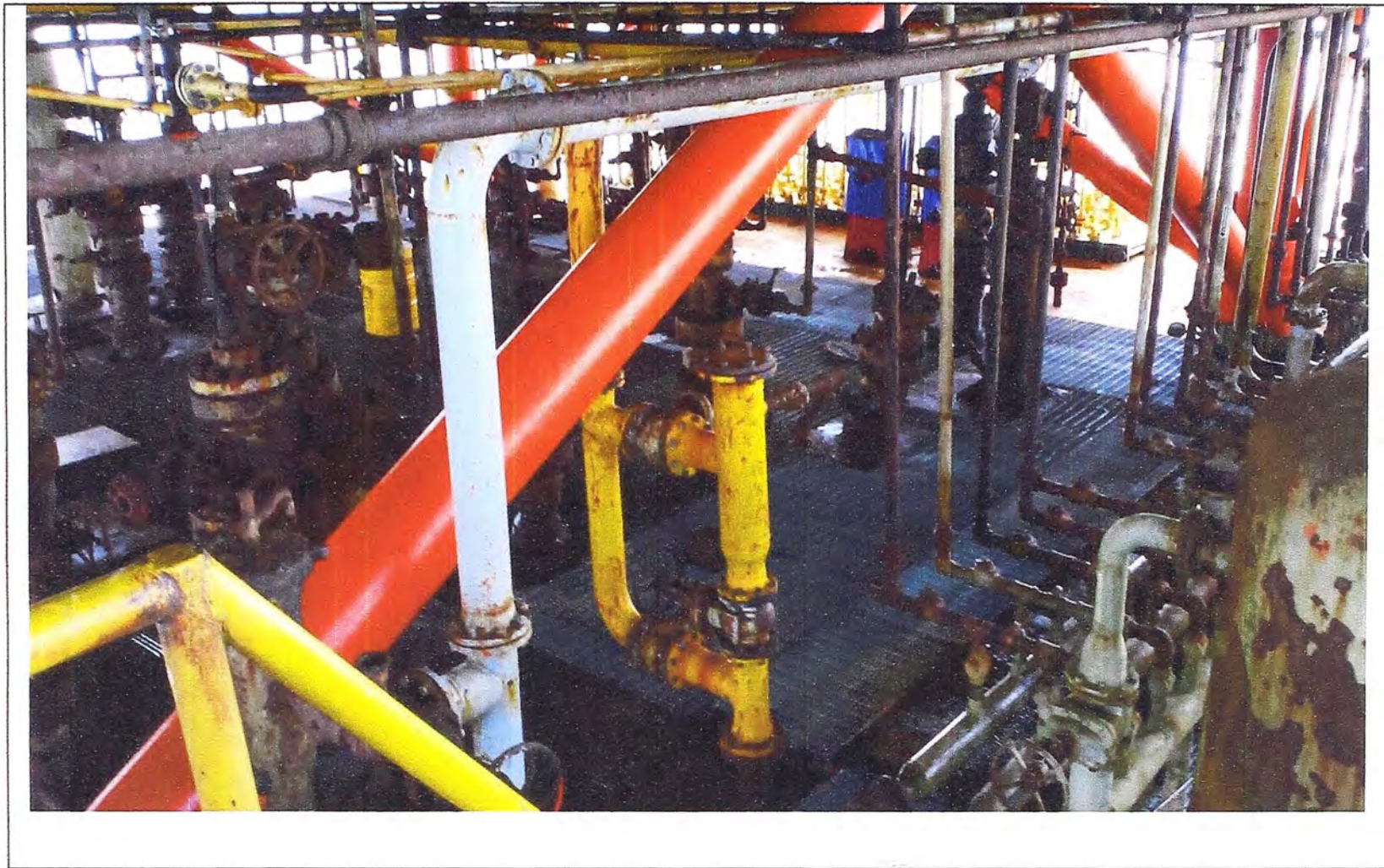
Figura 6.3 Piso de cabezales de pozos
