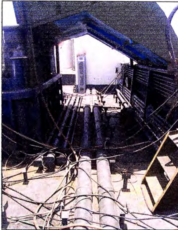
Fig. 3.13 Tuberías Hidráulicas – Winche de Pesca y borda de embarcación.
