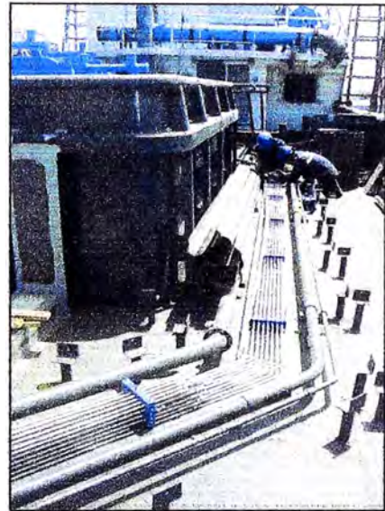
(b) Tuberías hacia consola hidráulica
