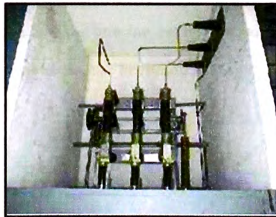
Figura 2.2. Celda de media tensión de construcción civil.
