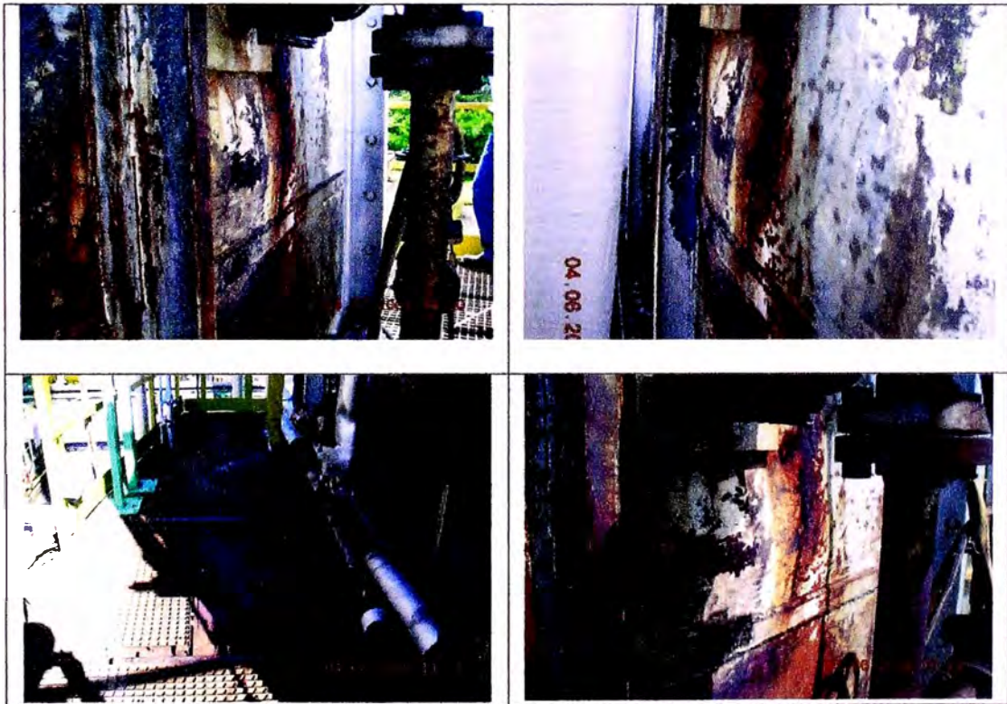
Fig. 3.5. Hinchamiento de la plancha metálica que recubre el panel frontal de la zona convectiva por el sobrecalentamiento en esa zona.
