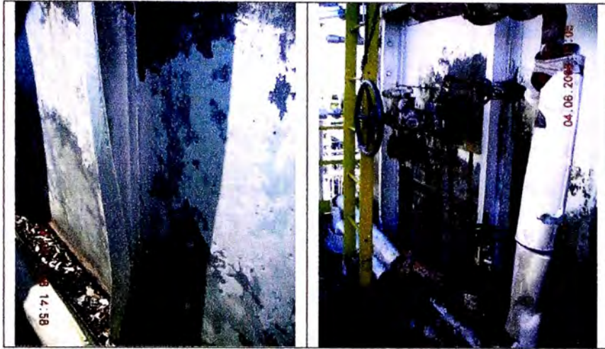
Fig. 3.6. Elementos estructurales que han sufrido deformación.
