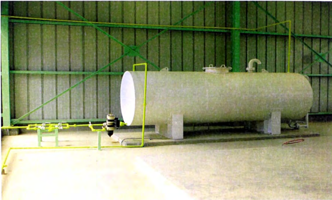
TANQUE DE PETRÓLEO
