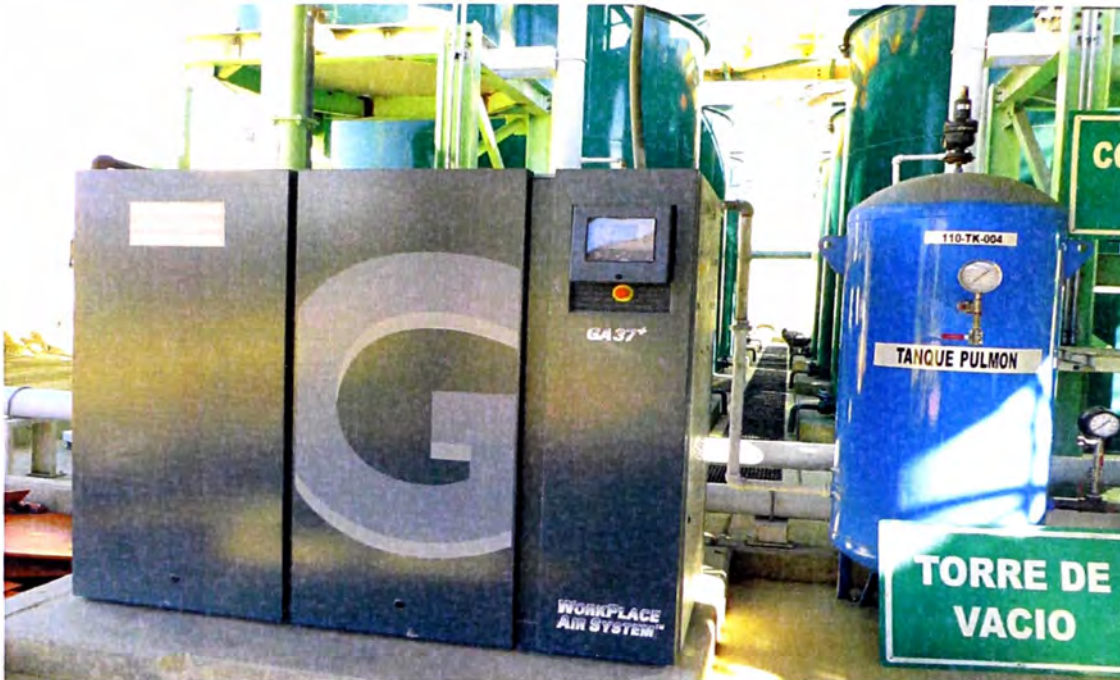
COMPRESOR DE AIRE Y TANQUE PULMÓN
