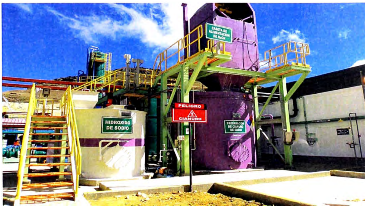
TANQUE HIDRÓXIDO DE SODIO Y PREPARACION DE CIANURO
