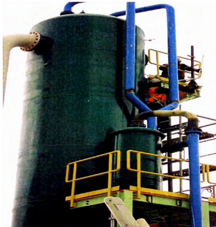
TORRE DE VACIO O DESAERADORA
