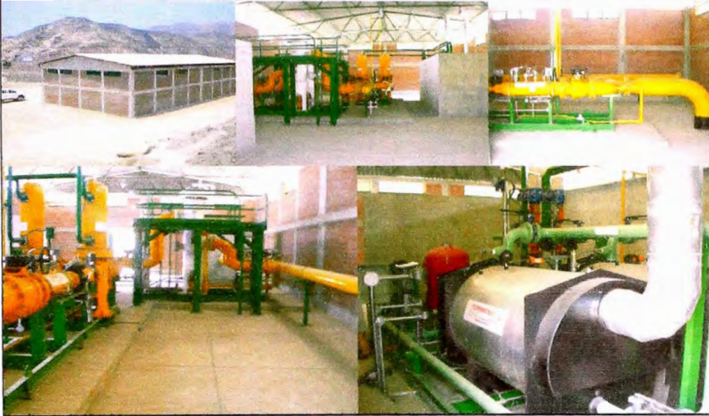
Estación de reducción de presión (espalda de arco sur del estadio de Atocongo)
