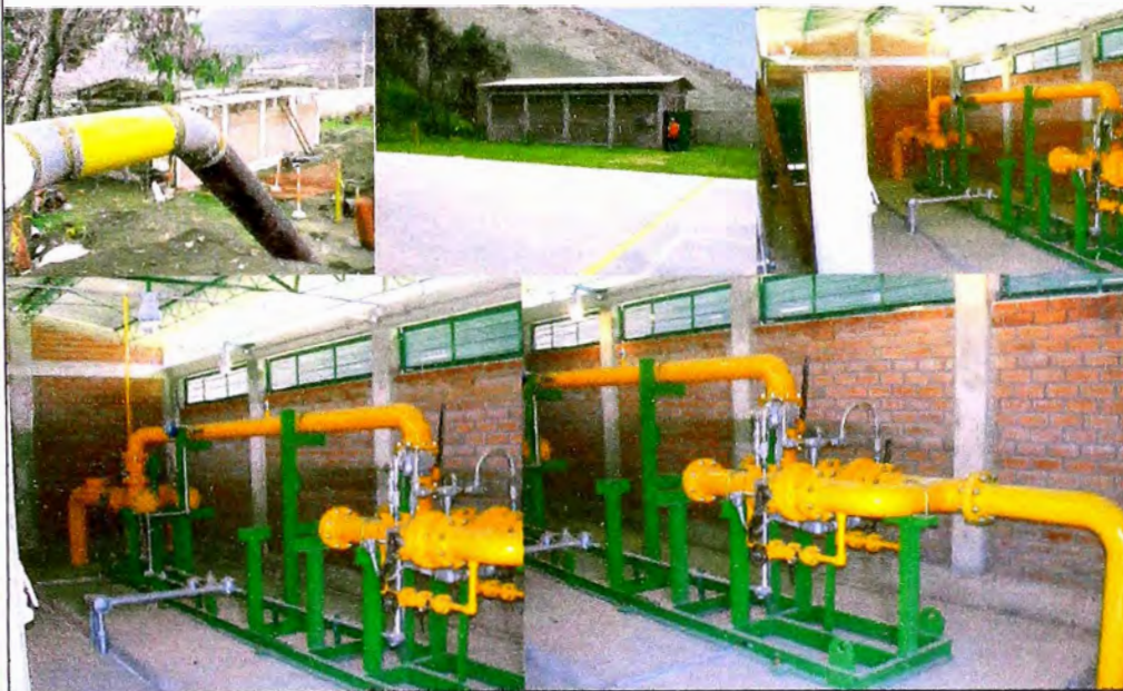
Estación de regulación y medición para suministro de gas a motores de GEA (Costado de cancha de losa de GEA)
