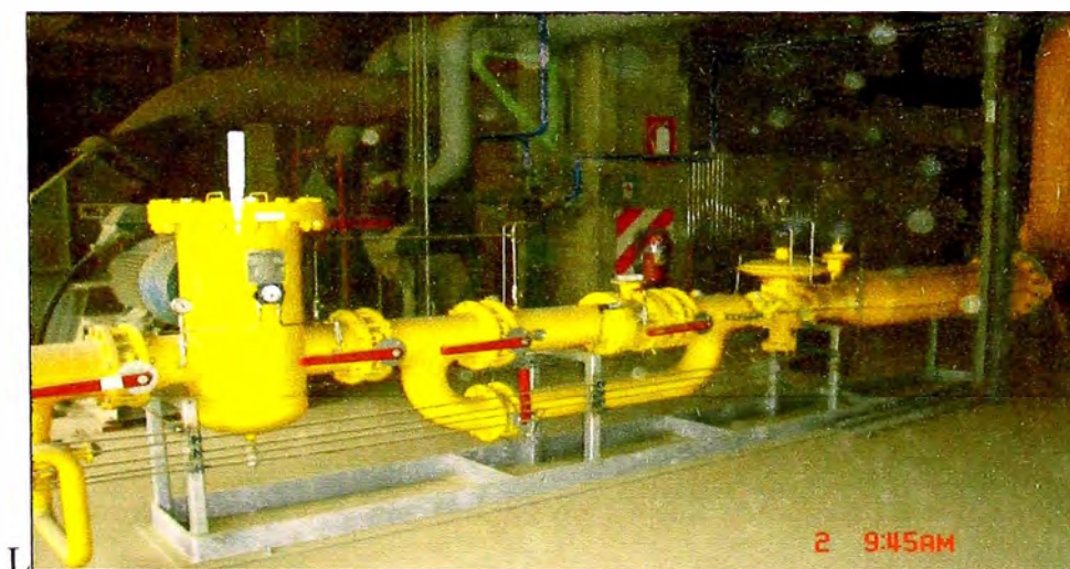
Figura 3.11 – Tren de válvulas de Reducción de presión
