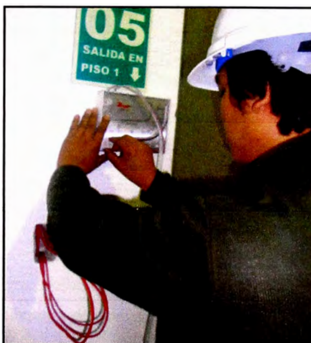
Fig. 2 Registro de mediciones de los diferenciales de presión.
