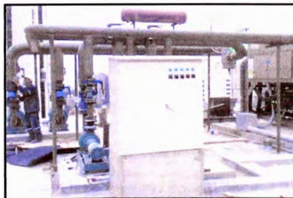
Figura 5.- Tablero de Bombas Secundarias
