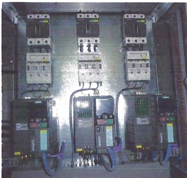
Figura 6.7. Variadores de velocidad y soft
