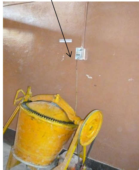
Instalaciones Electricas con llave cuchilla
