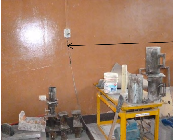
Cables eléctricos expuestos
