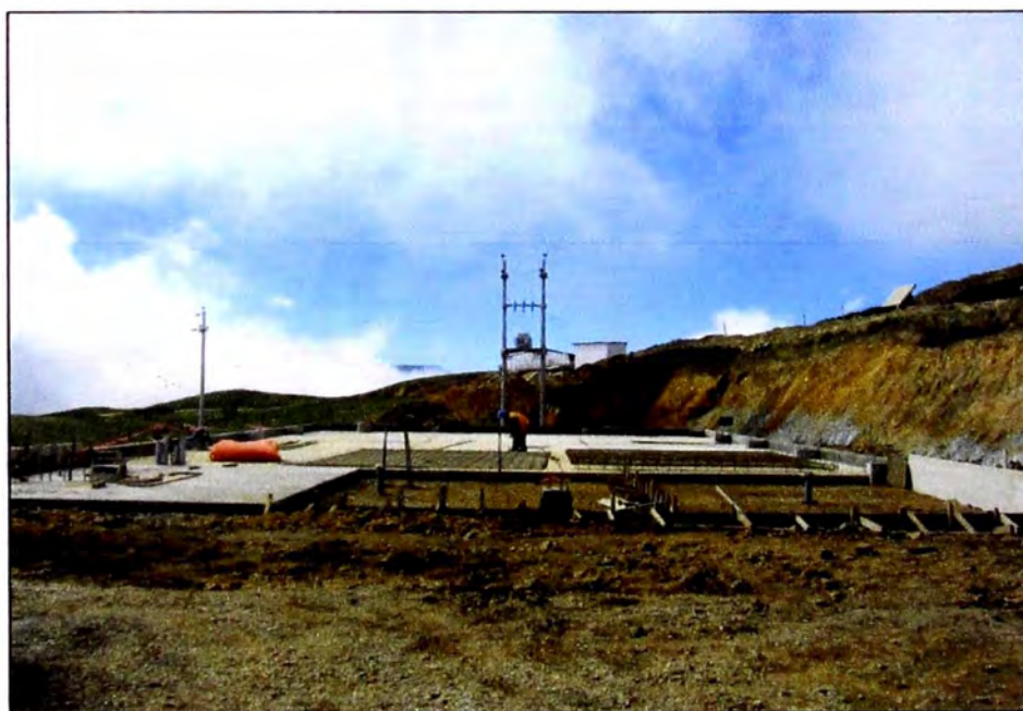
Fig. 3.1 Falta completar losa y sardinel. Visita efectuada el 04/05/10
