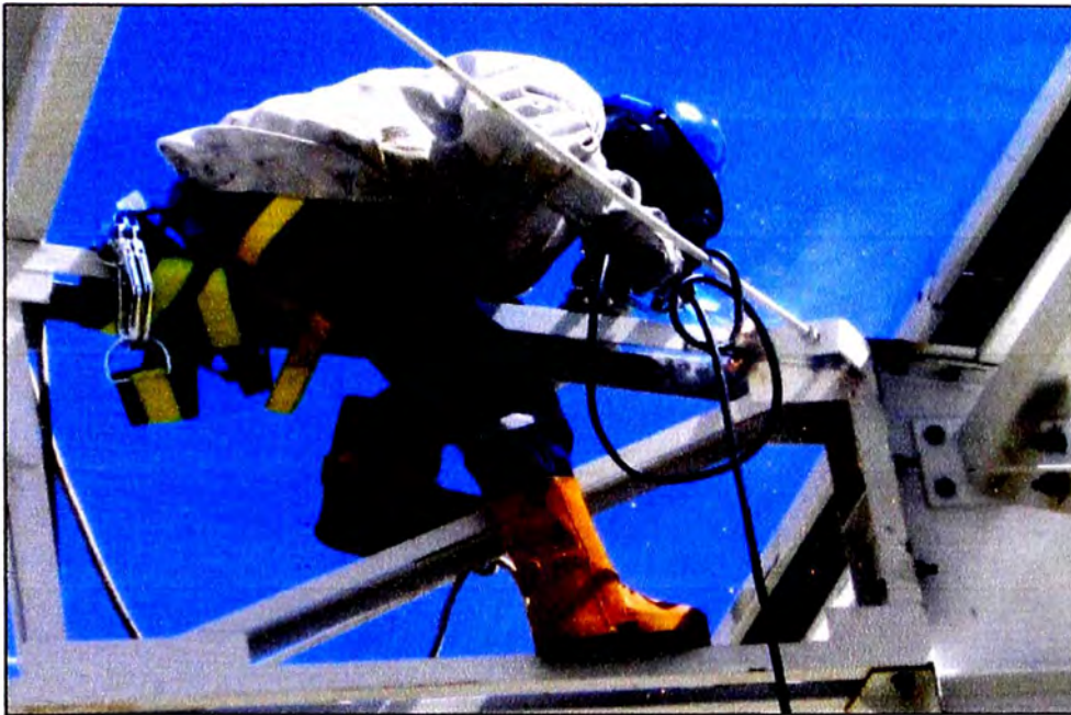
Fig. 3.36 Soldadura de la placa de amarre entre la columna y el tijeral
