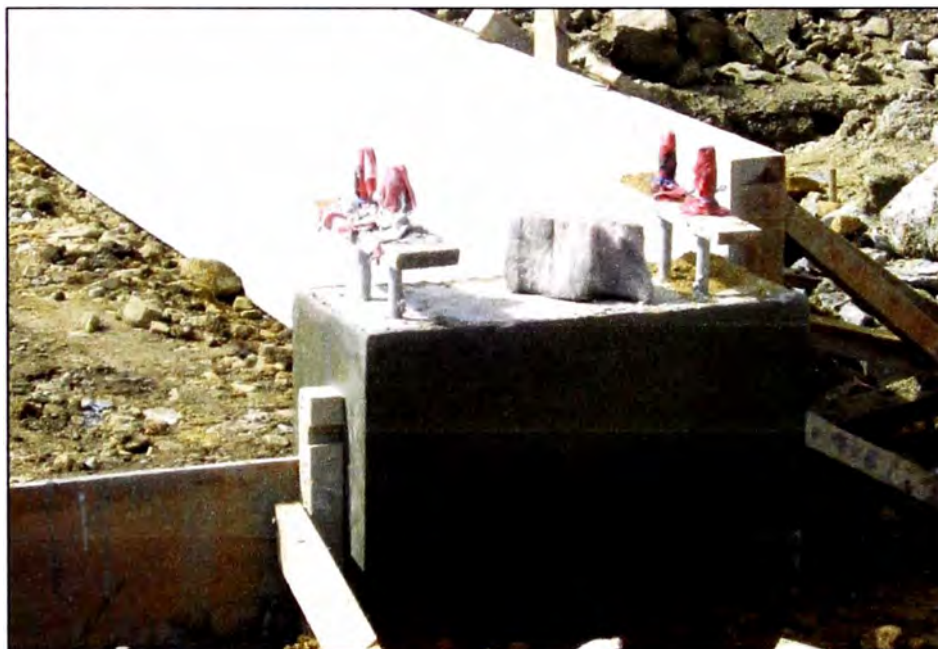
Fig. 3.2 Altura libre barras anclaje 250mm. Visita efectuada el 04/05/10
