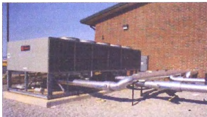
Fig. 2.6: Enfriador de agua (Chiller)
