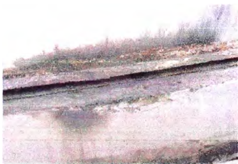
Fig. 4.9 Humedecimiento por diesel en pestaña del fondo.
