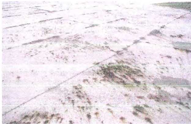
Figura 3.2 Techo del tanque con corrosión generalizada.
