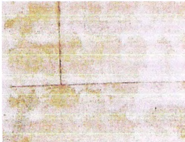
Figura 3.3 Cilindro del tanque con corrosión generalizada.
