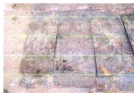
Fig. 4.6 Las planchas del fondo presentan corrosión casi nula en el lado inferior.
