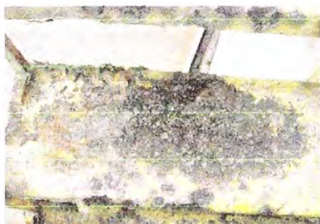
Corrosión generalizada de escalera de acceso al techo.
