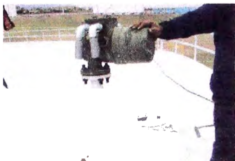
Fig. 4.21 Mantenimiento del sistema de medición de nivel.
