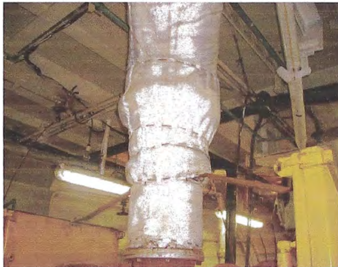
Fig. 4.4 Ducto de escape
