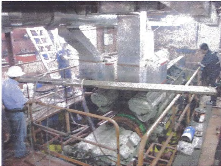
Fig. 4.1 Ductos de escape de un motor marino
