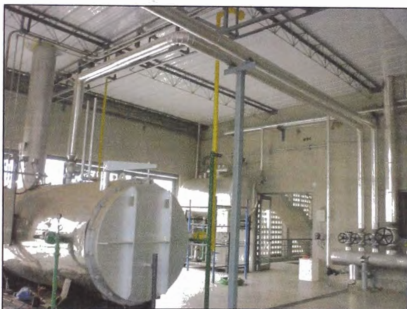
Figura 3.18 Sala de Calderas
