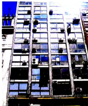
Figura 5.2. Instalaciones irregulares en los edificios
