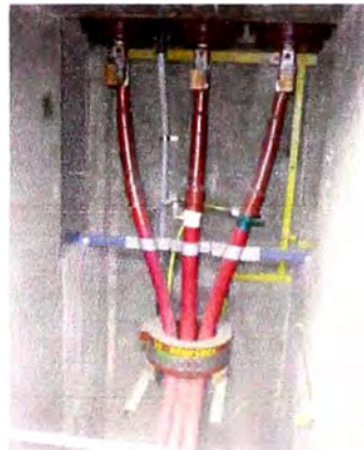
Figura 2.5. Cables en la salida del alimentador
