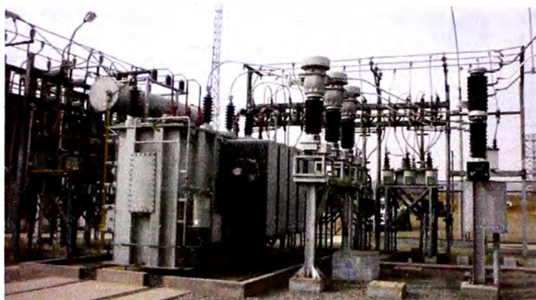
Figura 3.1. Subestación de transmisión de 60/22.9/10 kV
