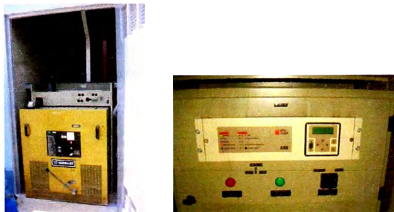
Figura 2.6. Equipos de protección
