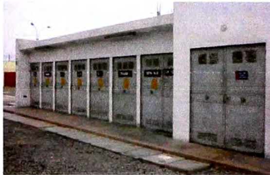
Figura 2.4. Celdas de salida de alimentadores
