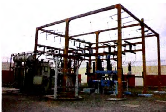
Figura 2.3. Subestación de transmisión
