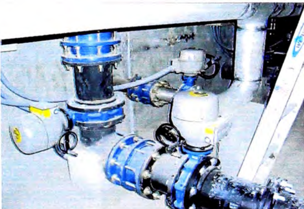
Foto N° 48 Válvulas de los filtros
