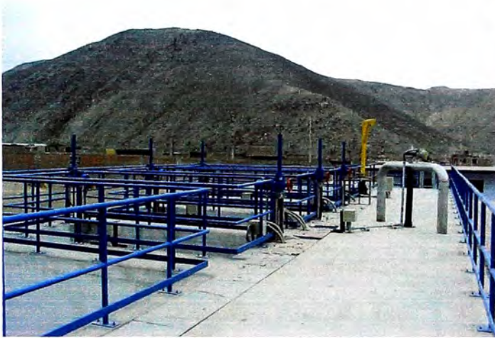
Foto N° 20 “Vista superior de los filtros”
