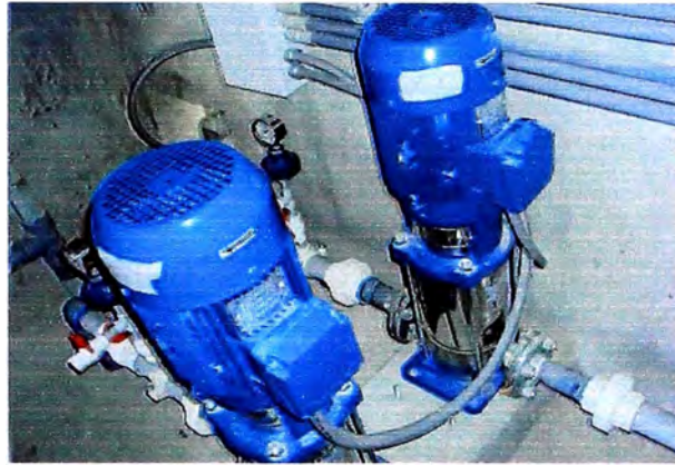
Foto N° 53 Bombas de Agua para sistema de cloración
