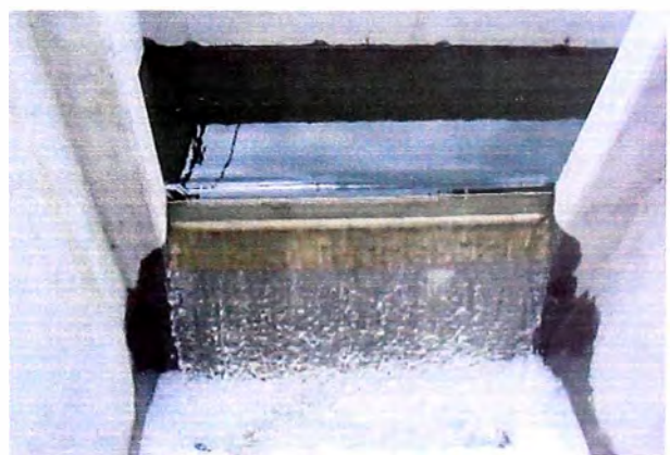
Foto N° 24 "Salida de la planta"
