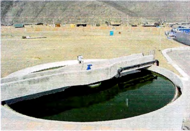
Foto Nº 55 Espesador de lodos
