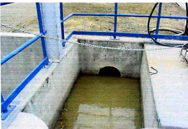
Foto N° 23 "Ingreso de Desagüe"
