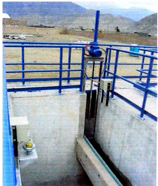
Foto N° 49 "Sensor de nivel y Compuertas"
