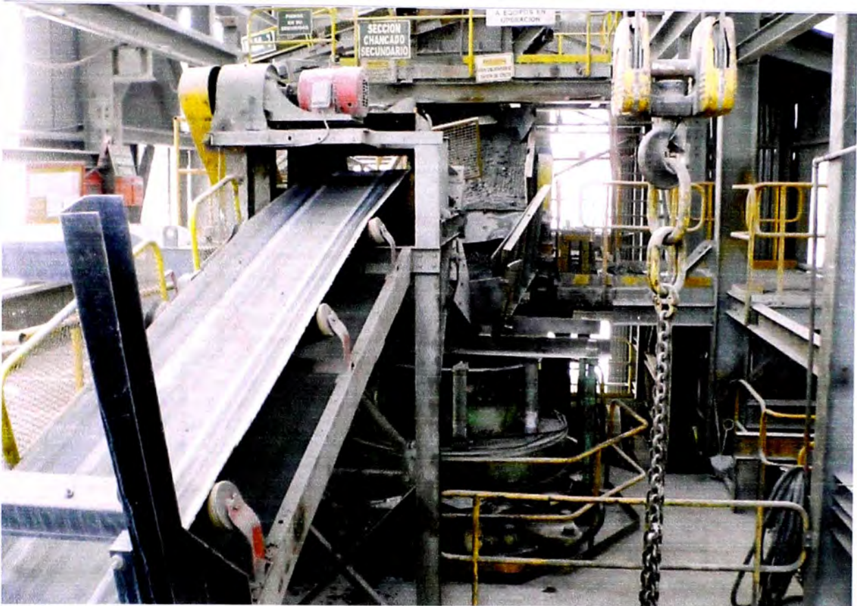
Figura 4.1: Equipo Chancador en funcionamiento
