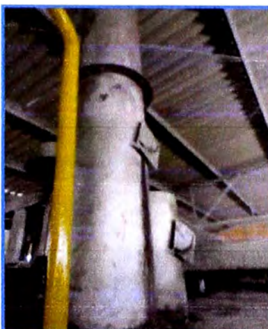
Figura 3.14. Chimenea y ducto de ventilación
