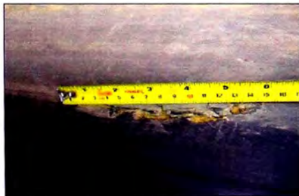
La foto muestra un corte del cover de 14 cm aproximadamente (criticidad 3)
