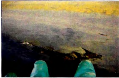
La foto muestra un corte del cover de 12 cm aproximadamente (criticidad 5)
