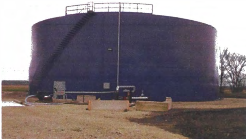
Figura 3.6: Tanque de almacenamiento de UAN de acero
