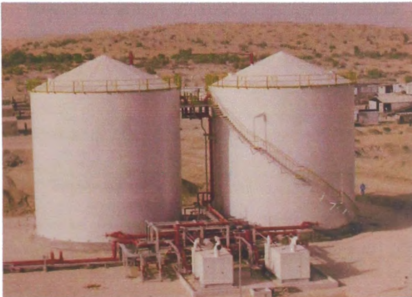
Figura 2.1: Tanque de agua de reserva contra incendios
