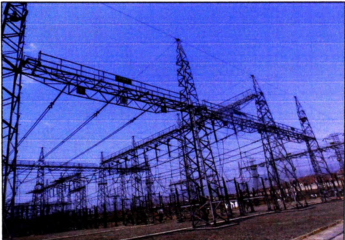
Figura 2.3 Patio de llaves inferior de 220 kV
