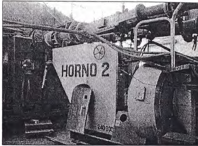
Figura 3.11: Cabezal del horno y del inyector de combustible
