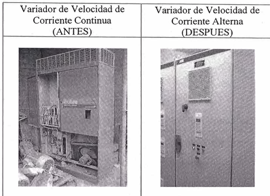
Figura 7.8: Variadores de Velocidad de Corriente Continua y Alterna
