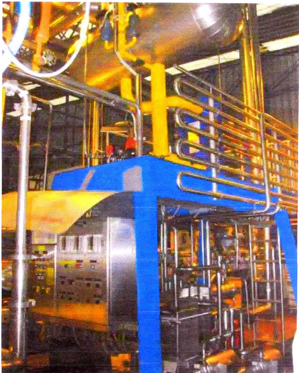
FOTO 01: VISTA PANORÁMICA DEL PASTEURIZADOR
