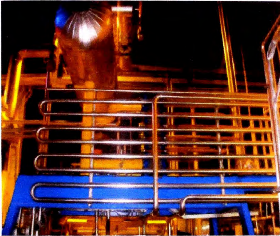
FOTO 02: VISTA DE SERPENTIN DE MANTENIMIENTO, INTERCAMBIADOR M6 Y SISTEMA DE REFRIGERACIÓN
