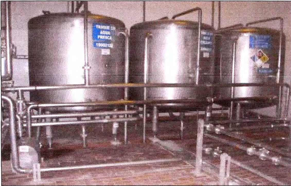
Figura N° 2.5 Instalación del sistema de limpieza Cip de la planta
