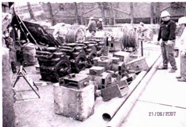
VISTA DE LOS GRUPOS ELECTROGENOS Y BOMBAS
