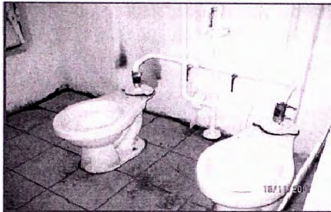
Figura 3.32: Vistas de las líneas de agua salada usados en los waters.
