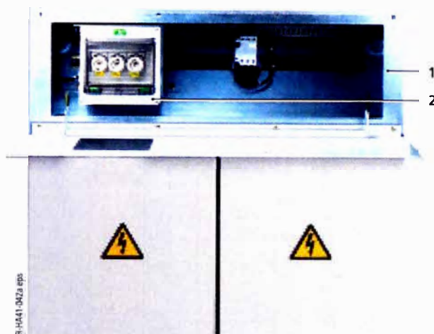
Nicho de baja tensión de una celda de medida de facturación tipo M, cubierta desplegada
