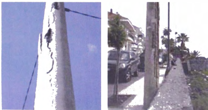
Fig 17/18 Fragmentación de la cobertura de hormigón por corrosión de la armadura (corrosión intensa por sal marina)
