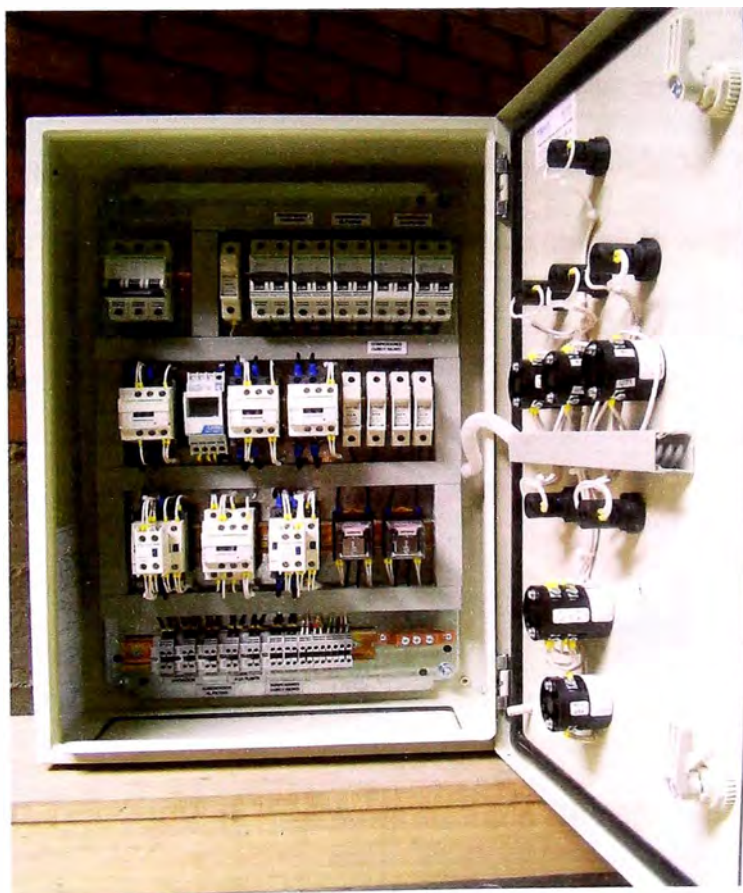
Fig.4.32 Tablero de control eléctrico
