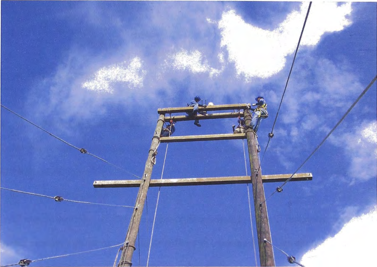
Fig. N° 4.10: Se puede apreciar los postes y crucetas de madera, así mismo se ve el cable de acero para retenida con su respectiva ferretería.
