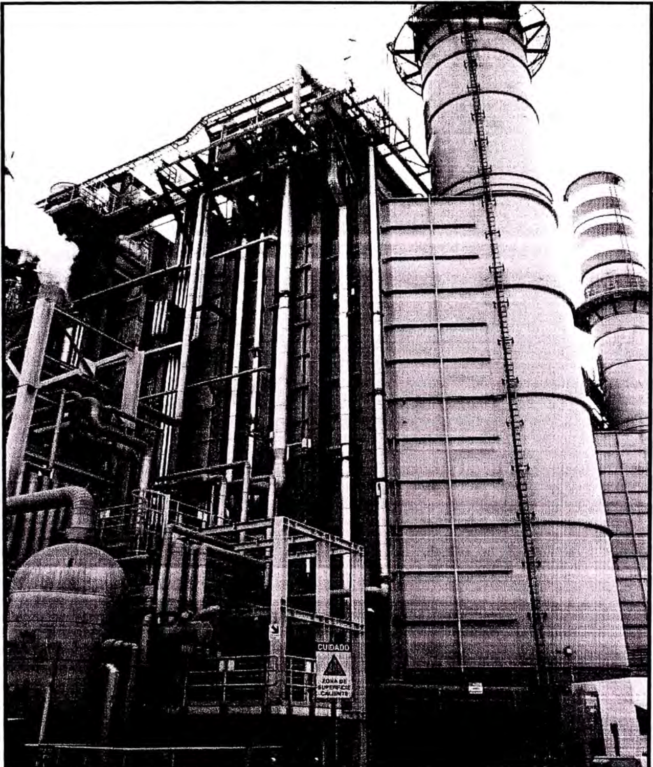
Figura. 2.26. Caldera recuperadora de calor (HRSG)
