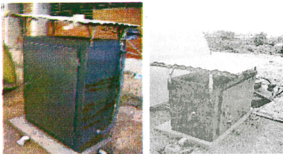
Fig. 9 Gabinete mayor y menor con equipos eléctricos.
