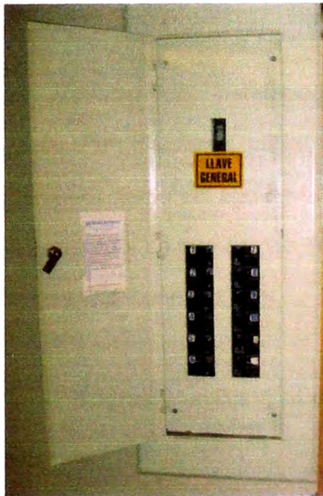
Fotografía 3-1.- Tablero general del operador que no tiene el sistema de barra partida.
