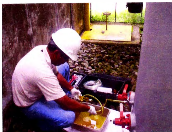
Retiro de muestra de aceite del transformador para prueba de Rigidez dieléctrica
