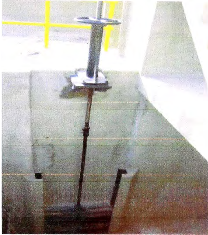
Figura N°- 2.1 : Compuerta plana accionada por volante
