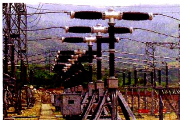
Figura 2.2-2: Subestación tipo AIS
