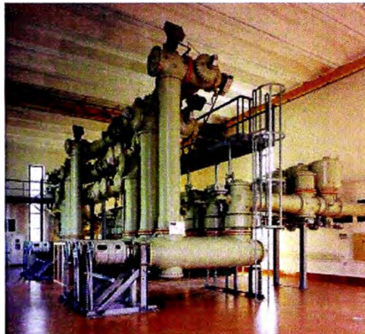
Figura 2.2-3: Subestación tipo GIS
