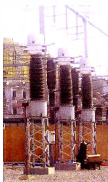
Figura 2.3-7: Transformadores de Medida
