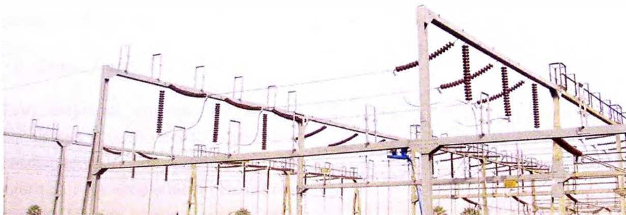
Figura 2.4-1: Vista de Sistema de Embarrado de Subestación Eléctrica
