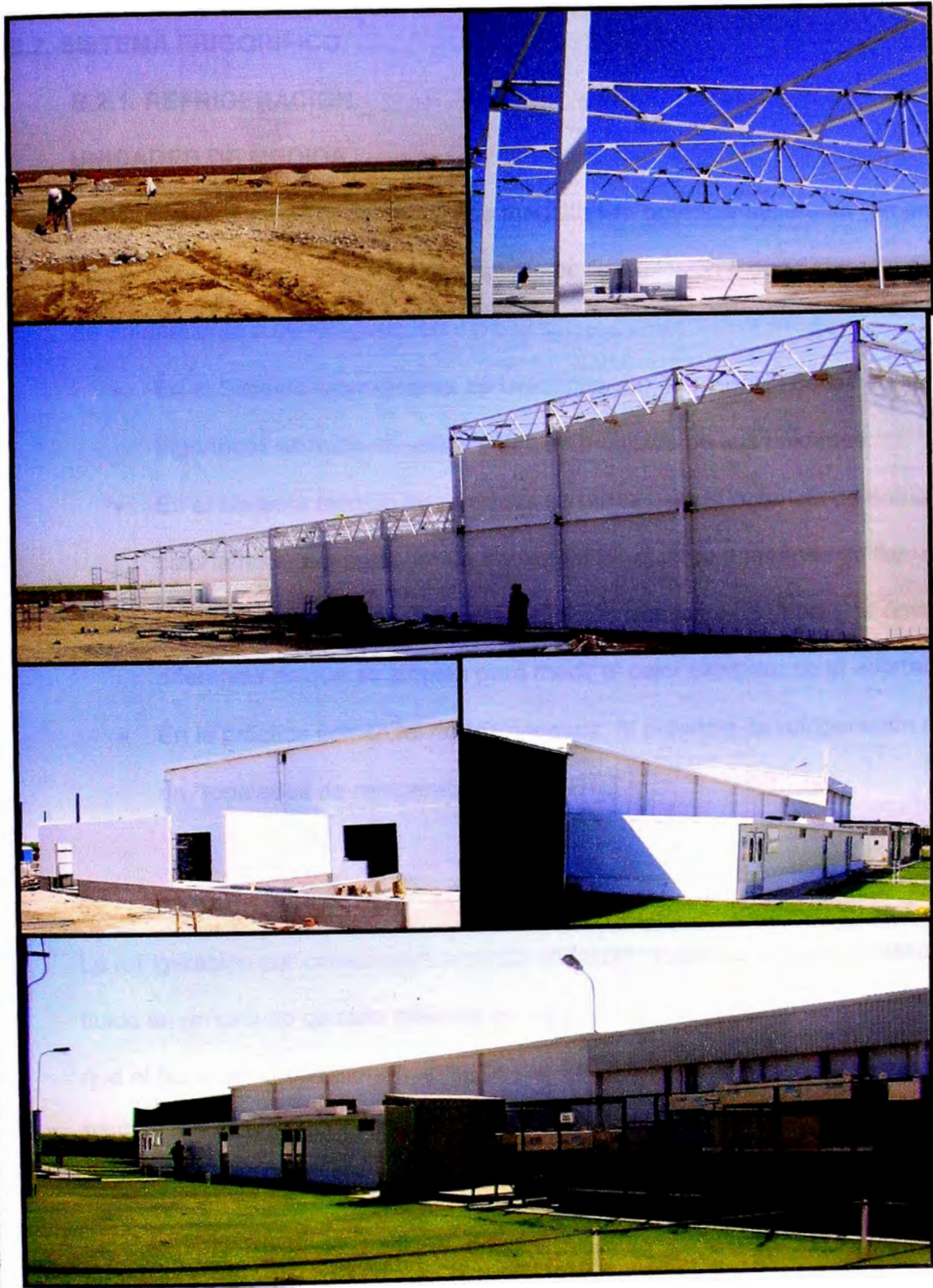
Figura 5. Panel de poliestireno instalado en el proyecto de la planta empacadora de uva.
