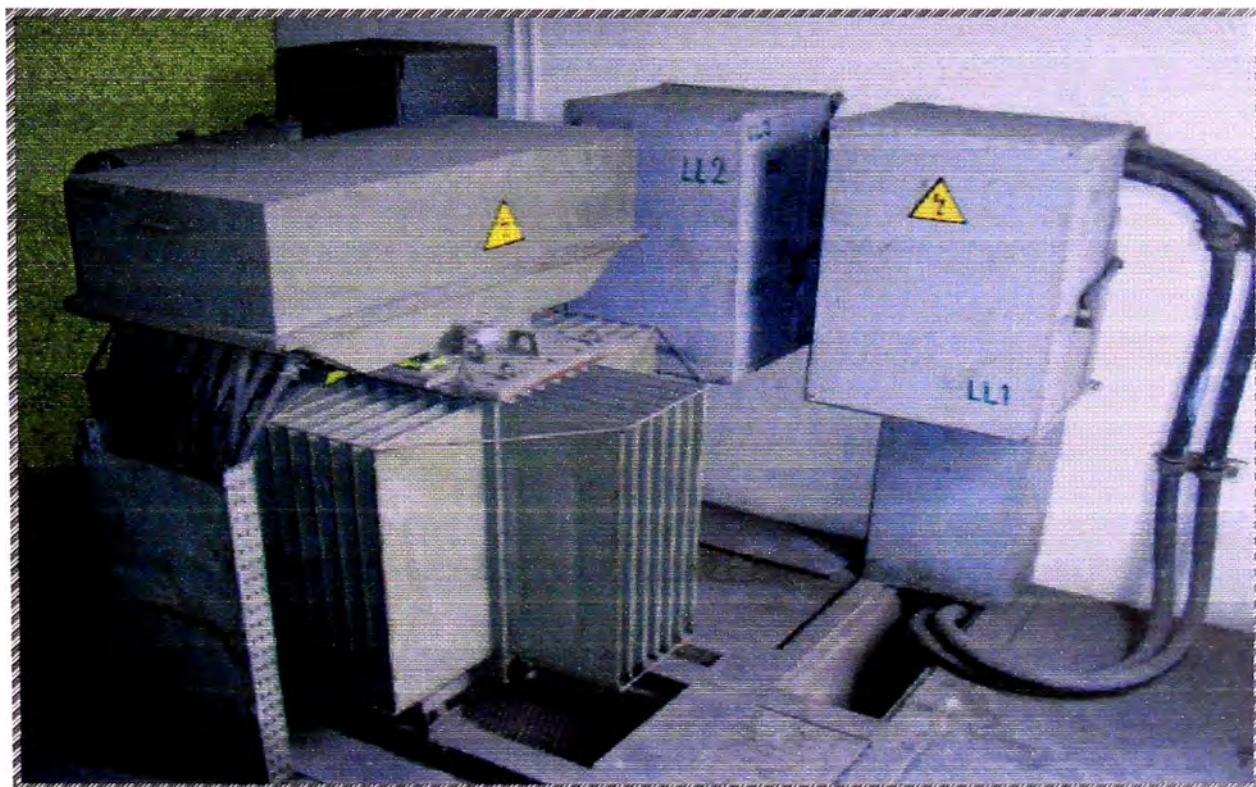
Figura N° 24 – Transformador y llaves del circuito de alimentación (fuerza)
