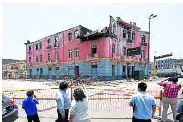
Gráfico 1.3.2: Fachada del edificio después del incendio
