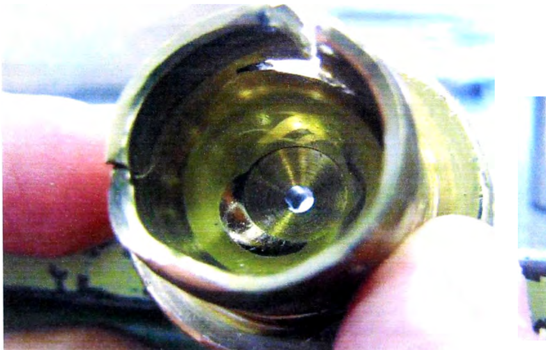
Figura N° 4.2 Zapata con fractura
