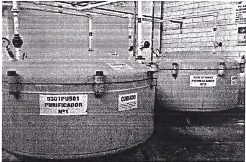
Fig. 2.2 Purificadores de Acetileno
