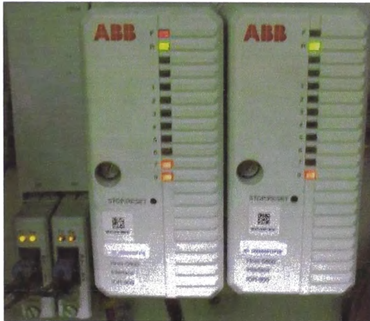
Figura 4.2. Módulos IOR800 Redundantes
